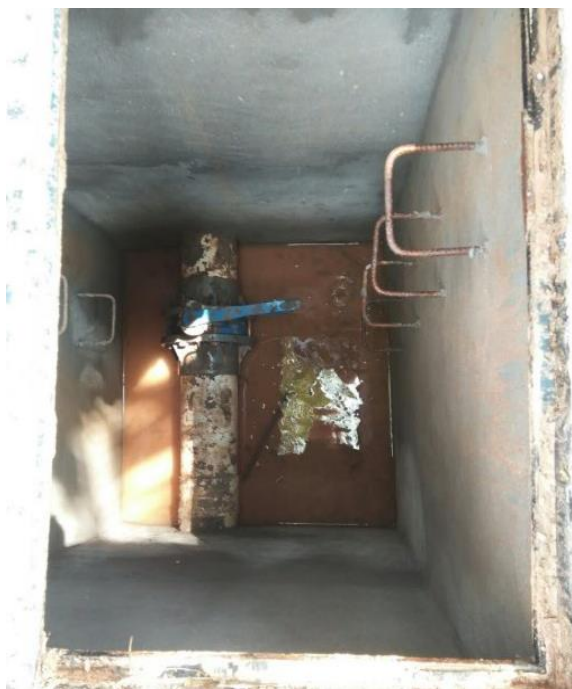
图 10.12-7 电镀污水站应急阀门
