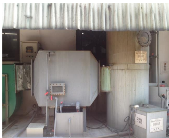
图 3-25 铬酸雾回收设施及处理设施图
