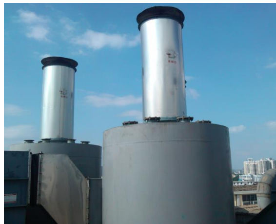
图 3-32 活性炭吸附塔及排气筒
