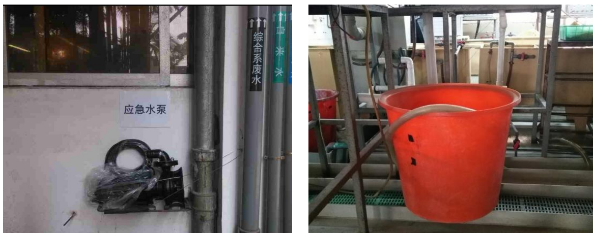
图 10.12-4 电镀车间备用槽、备用泵
