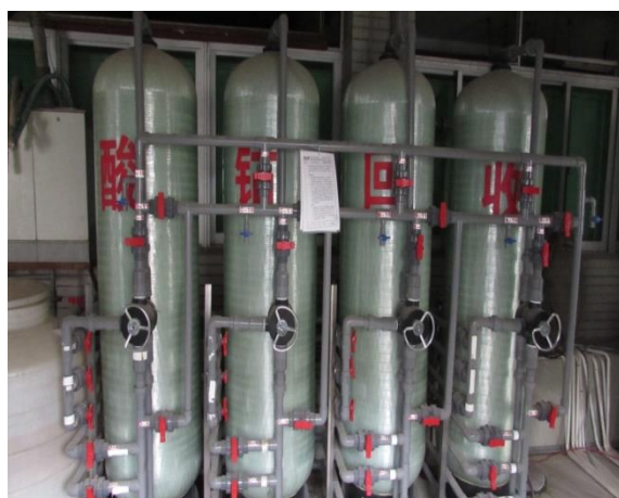
图 3-15 钴系废水处理设施图
