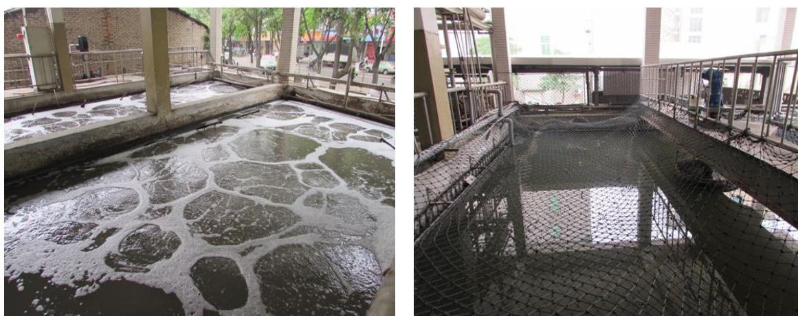
图 3-17 综合废水处理设施图
