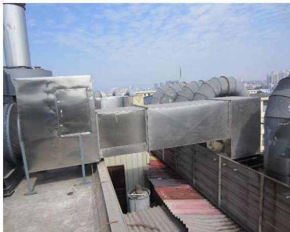
图 3-31 除湿除雾设施图
