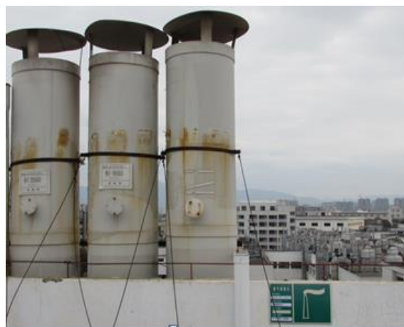
图 3-27 酸雾废气排气筒图
