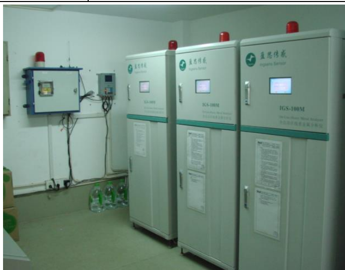
图 10. 12-1 电镀废水处理设施在线监控
